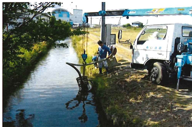
流末でポンプアップし水不足の 流域へ農業用水の反復利用
