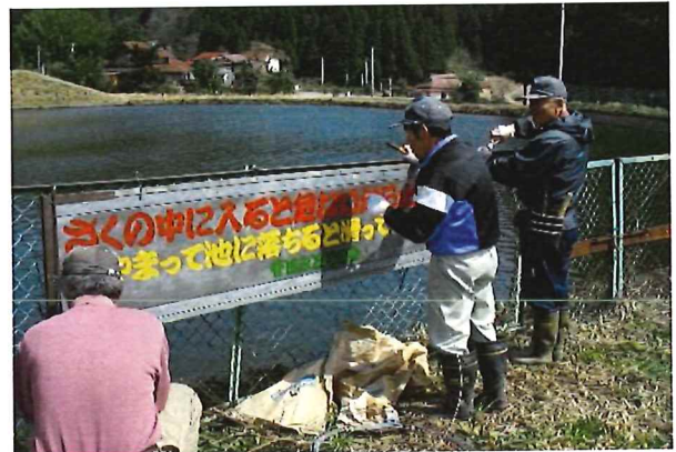
事故を未然に防止するための警告看板の設置と安全施設（フェンス）の補修
