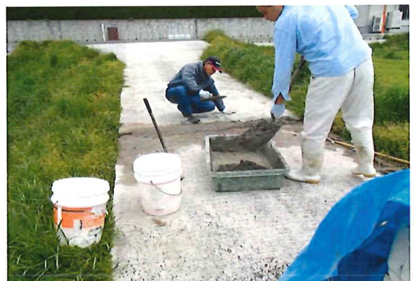
地震により破損した農道の応急措置
