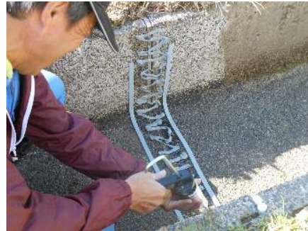
② シリコンシーリング材をコーキングガンで打設後、均一に塗りつけ。
