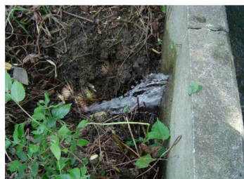
目地からの漏水状況
